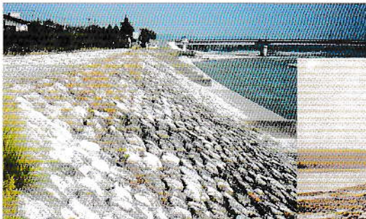
36災害以後、補強された出砂原堤防
